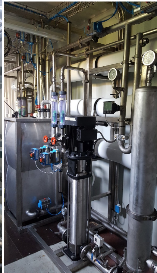
2° & 3° stage RO2/RO3 - spiral
